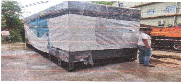
Gambar 2 : Dokumentasi Pengadaan Gebset 1000 KVA
